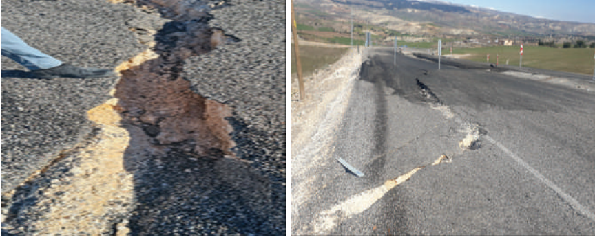
Şekil 71 – Adıyaman-Besni arasındaki yol göçmeleri 1
