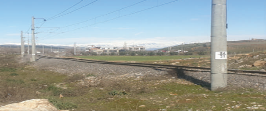
Şekil 68 – Hasar gören tren rayları 1 (Türkoğlu, Kahramanmaraş)
