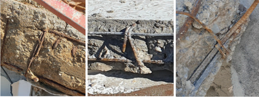
Yıkılan binalardaki etriyelerin büküm şekilleri (Adana)
