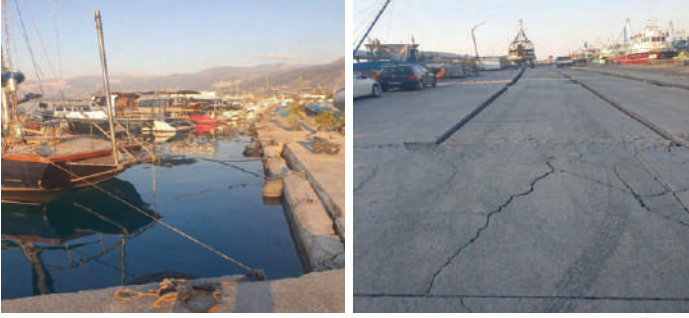
Şekil 5: İskenderun Balıkçı Barınağındaki yapısal hasarlar
