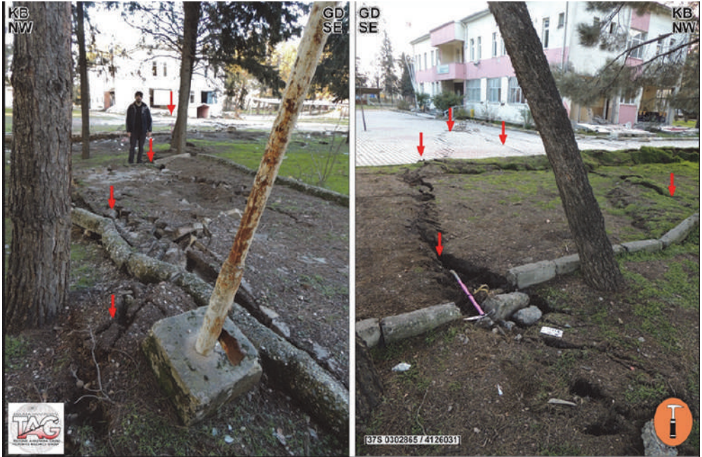
Şekil 12d: Yüzey yırtılmasının Şekeroba İmam Hatip Ortaokulundaki hasar ile ilişkisi. Konumlar için Şekil 12e'ye bakınız.
