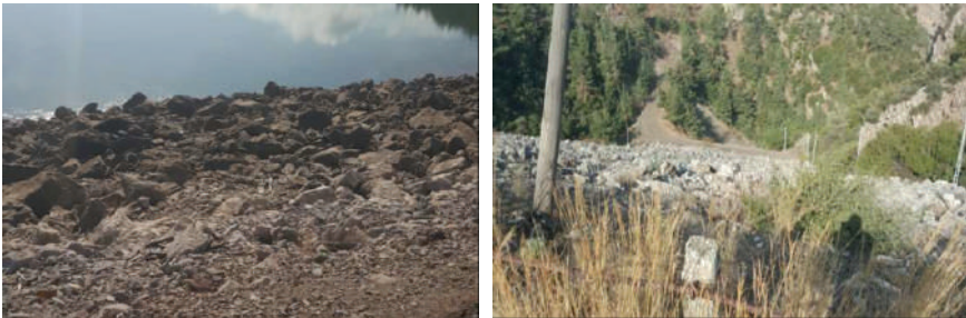
Şekil 34- Kalecik baraj gövdesi memba şevindeki deformasyon (sol)
