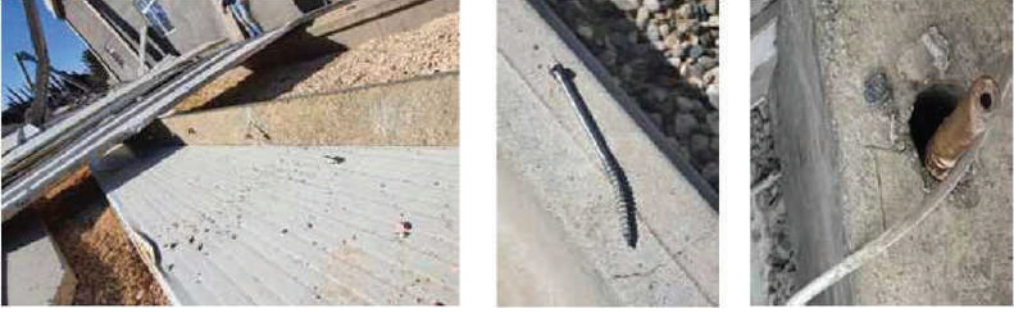
Çatı örtüsünün beton aşıkla yetersiz bağlantısı ve açık uç bağlantısında dolgu harçsız uygulama
