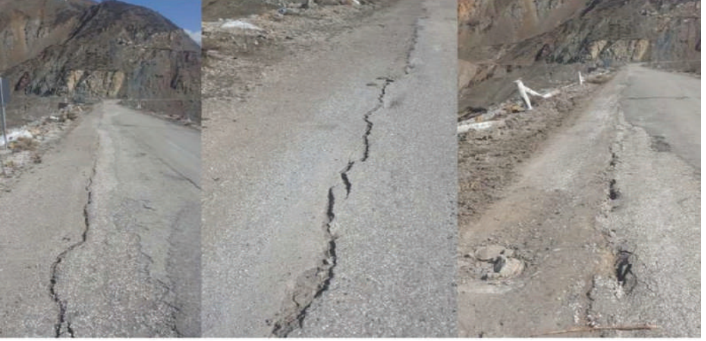
Şekil 12- Çat Barajı kretindeki sistematik çatlaklar
