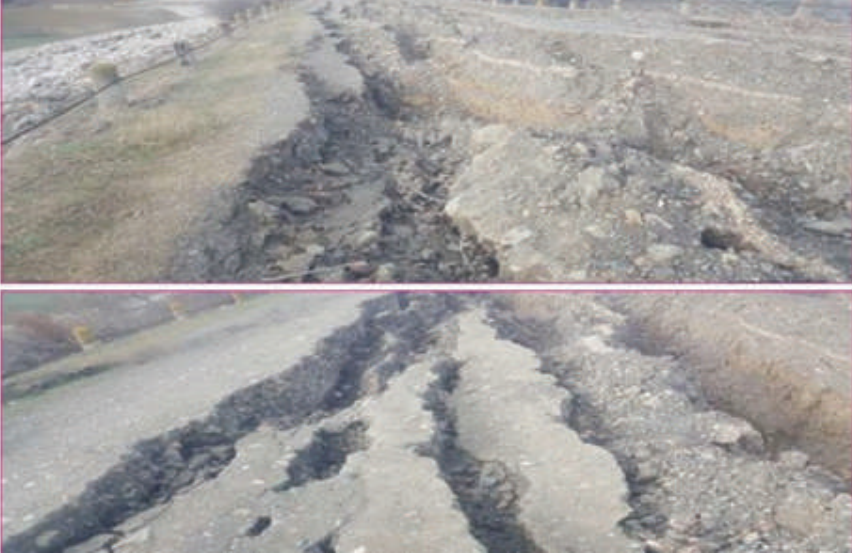
Şekil 30- Arıklıaş baraj kretinde oluşan derin çatlakların daha detaylı görüntüleri
