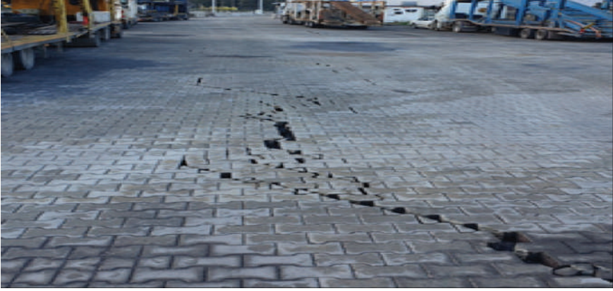
Şekil 67 – İskenderun Limanında Tır park alanı zeminindeki çatlaklar
