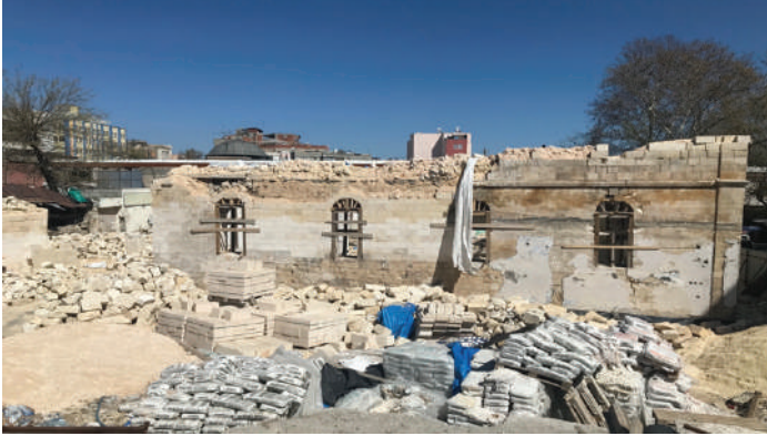
Adıyaman Çarşı Cami güney cephesinde kaplaması dökülen yeni duvar örgüsü
