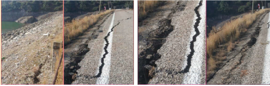
Şekil 32- Eksen yönünde (akışa dik) oluşan derin çatlaklar (sol)
