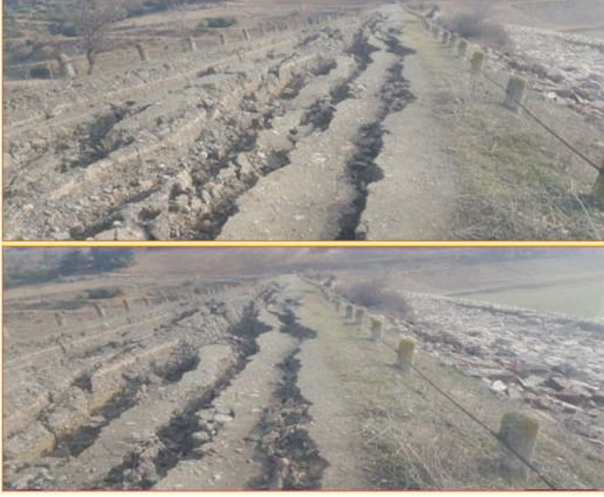
Şekil 28- Arıklıkaş baraj kretindeki derin çatlaklardan detaylı görüntü
