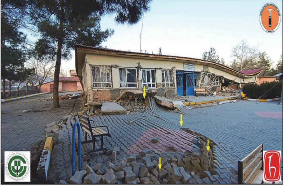
Şekil 12j: Yunus Emre Ortaokulu önünde yüzey yırtılmasının neden olduğu hasar.
