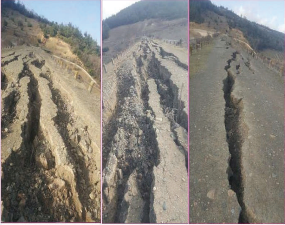
Şekil 29- Arıklıkaş baraj kretinde derin çatlaklar (ağır hasar)
