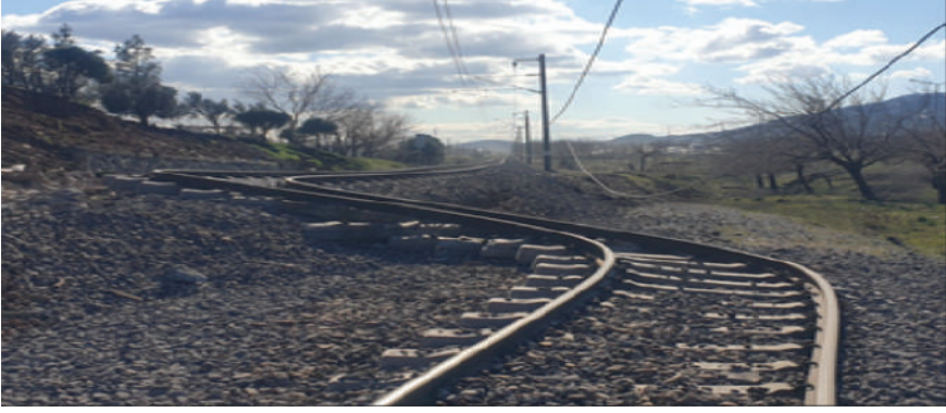
Şekil 69 – Hasar gören tren rayları 2 (Türkoğlu, Kahramanmaraş)
