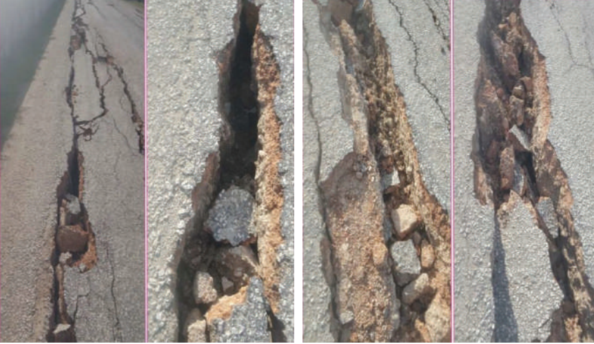
Şekil 39- Yarseli baraj kretindeki derin çatlaklardan detaylı görüntü (sol)
