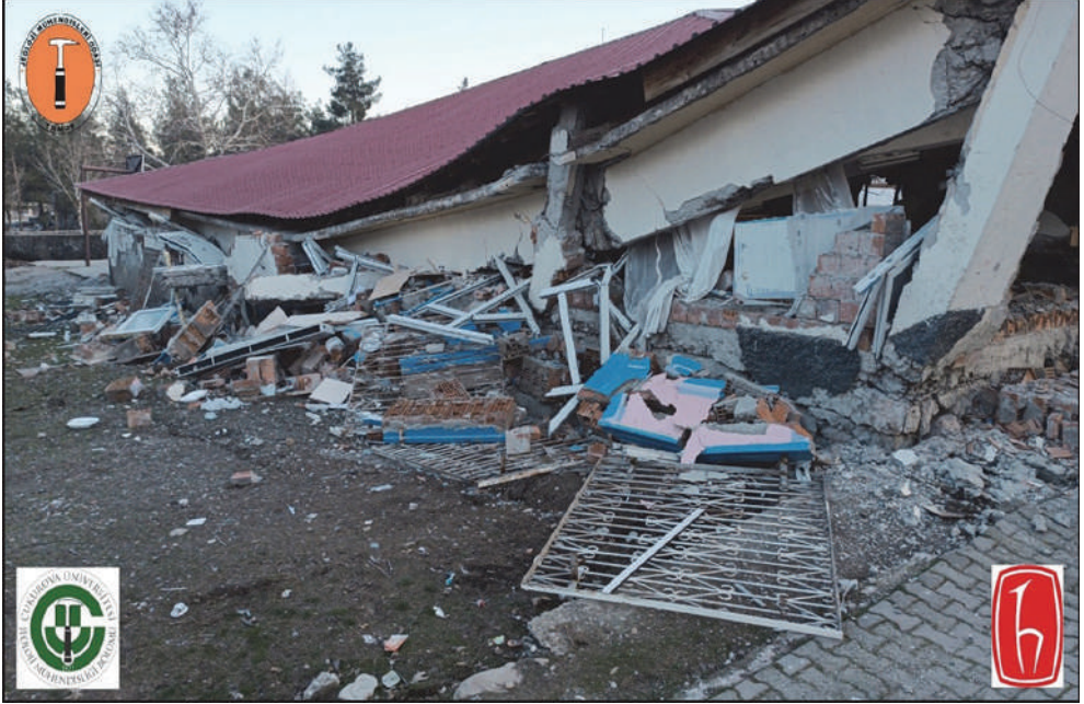
Şekil 12k: Yunus Emre Ortaokulu arka bölümünde yıkım. Yüzey yırtılması ile ilişkisi için Şekil 12f'ye bakınız.
