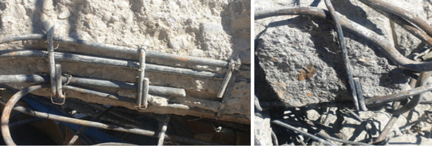
Yıkılan binalardaki etriyelerin büküm şekilleri (Besni)
