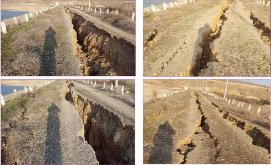
Şekil 3- Sultansuyu barajının depremden 10 gün sonraki görüntüleri
