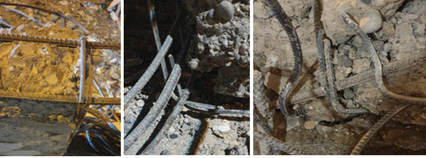
Yıkılan binalardaki etriyelerin büküm şekilleri (Adana)
