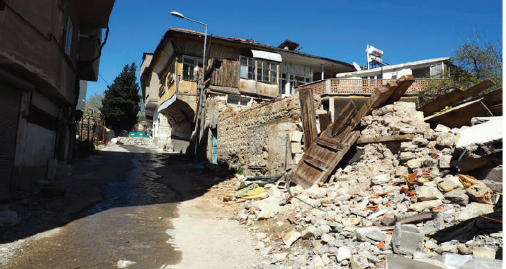
Kahramanmaraş merkez, önde yıkılmış geleneksel yapı, arkada sağlam durumda geleneksel yapı
