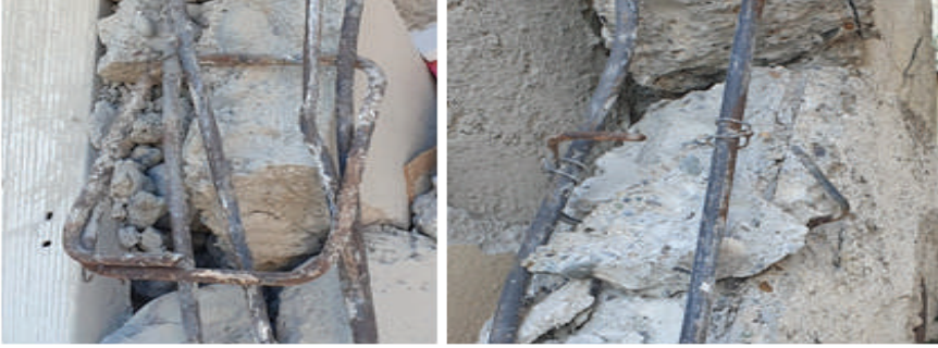
Yıkılan binalardaki etriyelerin büküm şekilleri (Osmaniye)
