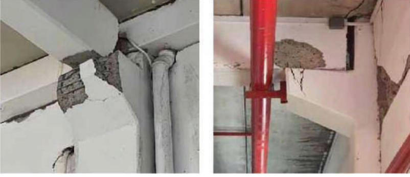
Kısa Konsol Hasarı
