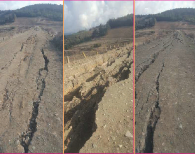
Şekil 27- Arıklıkaş baraj kretinde eksen yönünde (akım yönüne dik) görülen derin çatlaklar
