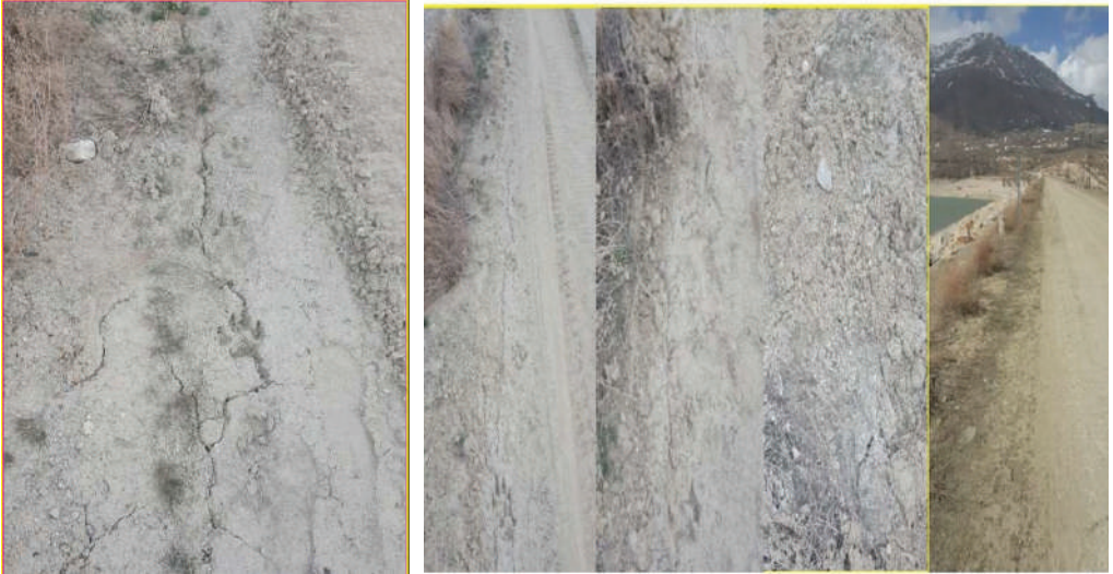
Şekil 20- Polat Barajı kretinde oluşan kılcal çatlaklar (sol)
