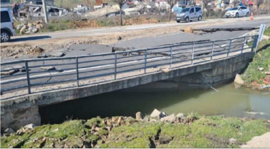
Şekil 73 – Nurdağı-Kahramanmaraş karayolundaki köprü çökmesi
