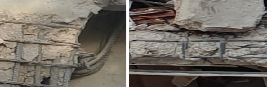
Yıkılan binalardaki etriyelerin büküm şekilleri (Antakya)
