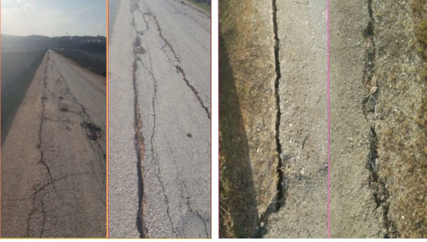
Şekil 37- Eksen yönünde (akışa dik) oluşan derin çatlaklar (sol)
