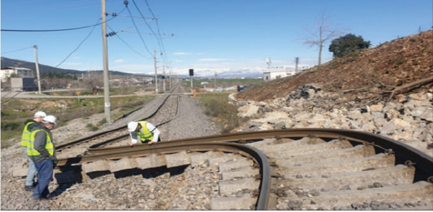
Şekil 70 – Hasar gören tren rayları 3 (Türkoğlu, Kahramanmaraş)
