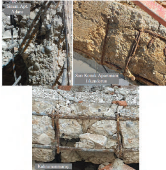
Yıkılan bazı binalarda gözlenen beton kalitesi
